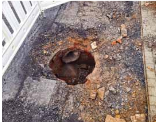
defekter Schacht beim Busstieg
